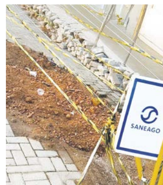
Buracos feitos por reparos da Saneago: incômodo generalizado na cidade
